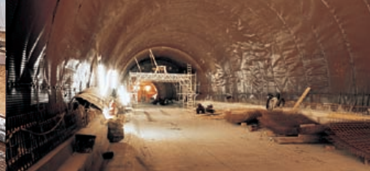
Drainage de surface efficace dans les tunnels.
